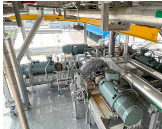
Beispiel: Industrielle Wärmepumpenlösung mit Verdichtern von Piller (GIG Karasek bietet Verdichter unterschiedlicher Hersteller an) © Piller
